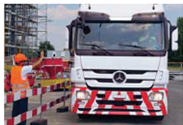
1 Verkehrswege für Personen und Maschinen/Fahrzeuge trennen.
